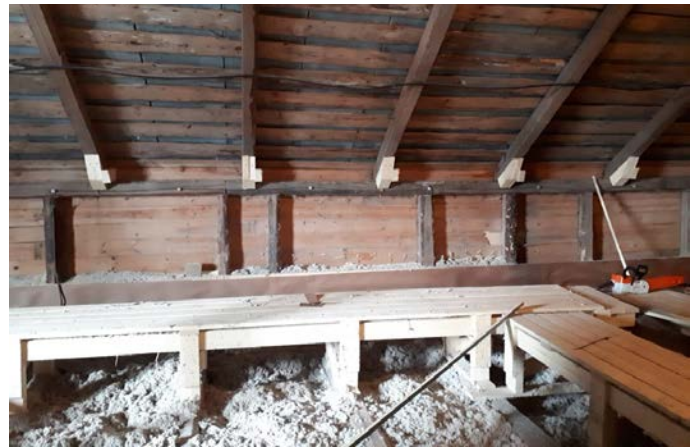
(8) Kun villa oli puhallettu ja osa eristykset oli tehty, oli kattotuolien varmistusten vuoro. Tavoitteena on estää katon liukuminen pois paikoiltaan kannakointeja korjatessa.
